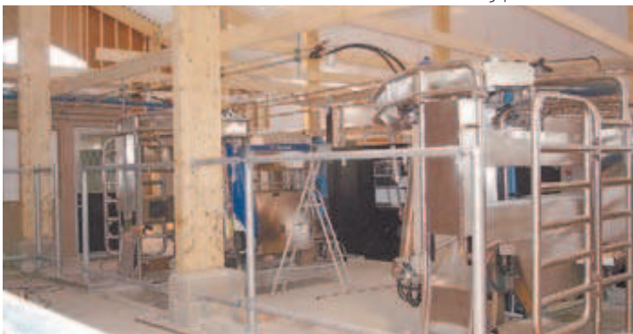
— Två stycken mjölkkningsrobotar har DeLaval installerat
